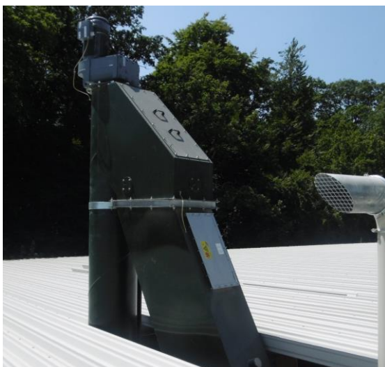
Fallschacht mit Berstscheibe
