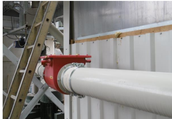
Zuluftleitung mit Rückschlagklappe
