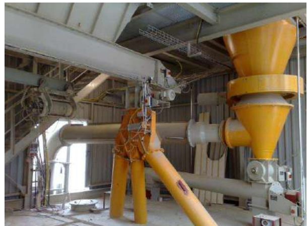
Sichterunterteil mit Förderer zur Kugelmühle
